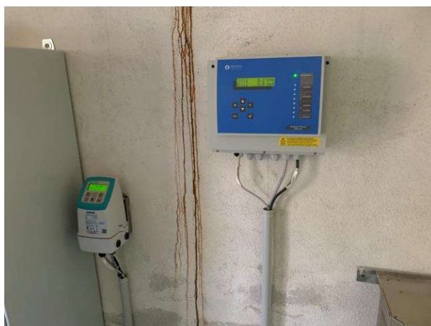
Figure 5 : Suivi de l'injection de chlore dans le local
